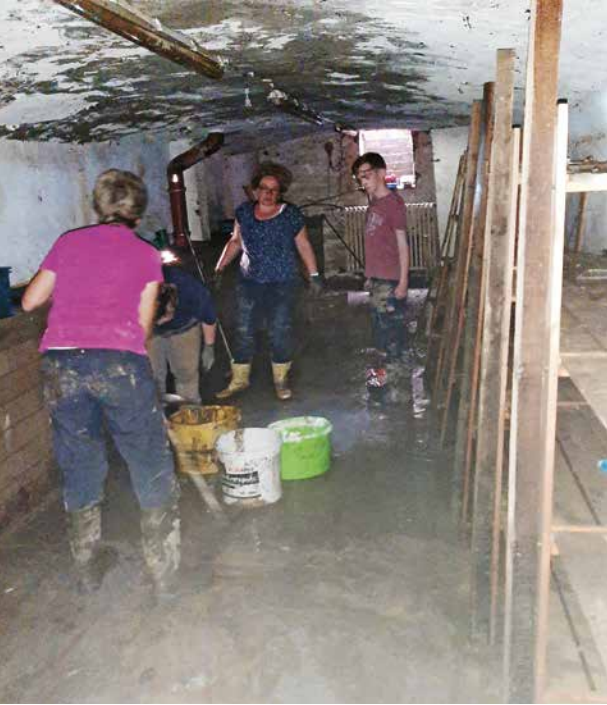
Kellerräume unter Wasser in Oberdrees
